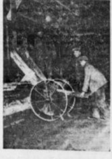
Tak oto wygląda „uprządkowanie” plac budowy na Osiedlu Mokotowskim w pobliżu ul. Wolskiej...
