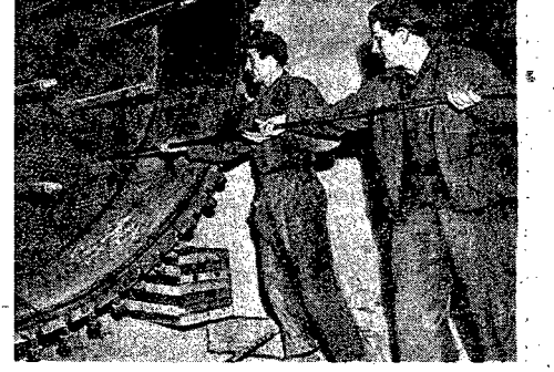
Z każdym dniem rosną wznoszą się nowe elektrownie „Miechoufer”. W każdym z nich halach montuje się już turbiny. Na zdjęciu monterzy produkującego zespołu Franciszka Wojtyłki - Marian Sobieraj i Stefan Nowacki kurkują kondensatory. Foto CAF - Kondracki.
