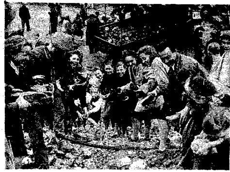
Młodzież ZWM biorąc udział w odguzowaniu Rynku Starego Miasta zabiera się energicznie do roboty. Cegły systemem taśmowym wędrują na samochód.
