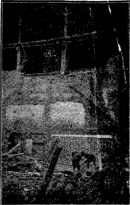
Katastrofa przy ul. Krochmalnej w Warszawie. Straszliwa katastrofa, która zdarzyła się w niedzielę rano przy ul. Krochmalnej, wstrząsnęła głęboko nie tylko mieszkańcami stolicy, ale rozeszła się szerokim echem po całej Polsce. Ilustracja nasza przedstawia usuwanie gruzów. Na ścianie widoczne są ślady zniszczonego budynku, który stał się grobem kilkunastu osób.
